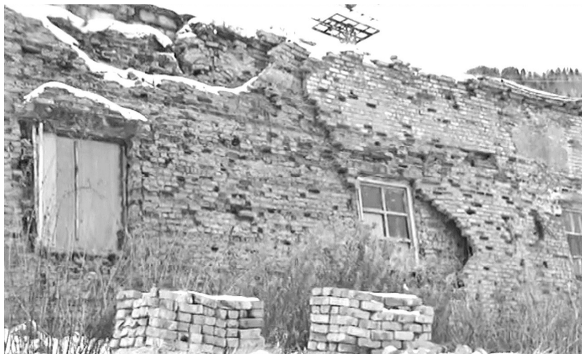
Вердикт помещению: не подлежит восстановлению
