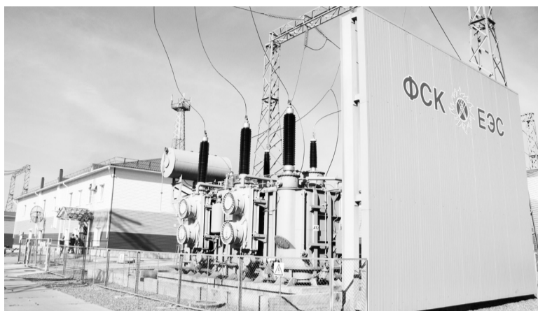
Подстанция 220 кВ Означенное-районная
