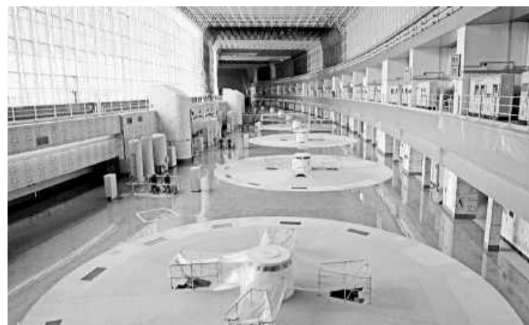
Машинный зал СШГЭС после модернизации
