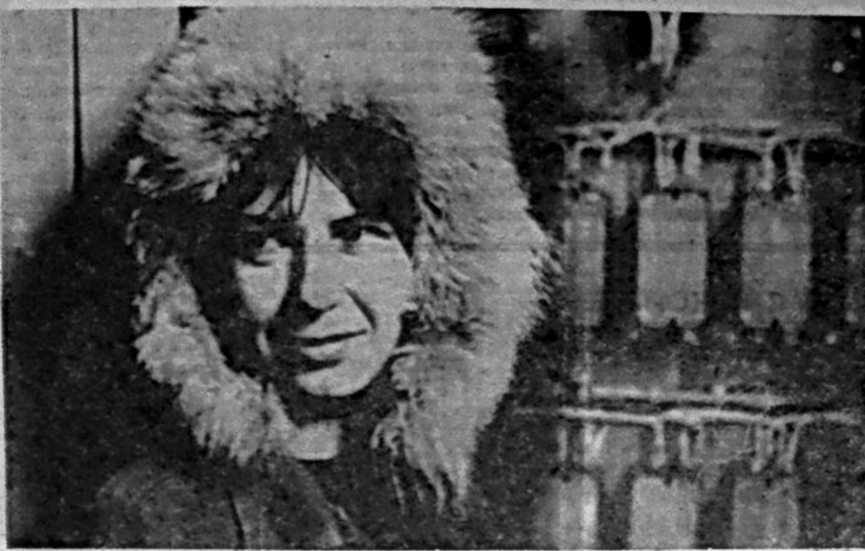
По-ударному работает Анна Дмитриевна Хомутова в завершающем году десятой пятилетки. Монтажница из ГЭМа со своими товарищами обслуживает высоковольтные распределительные устройства второго и третьего агрегатов.
