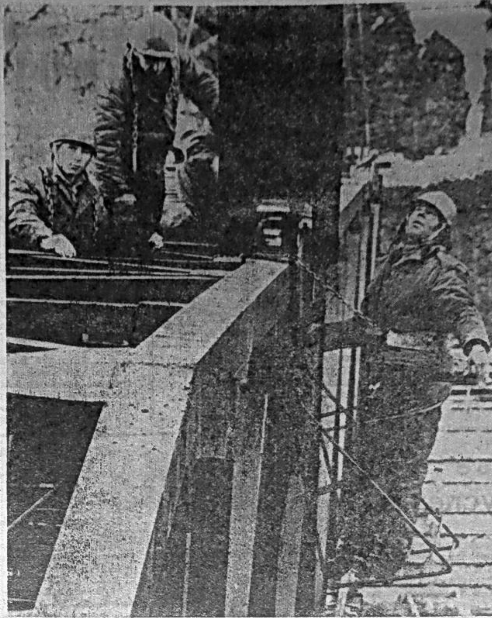
На ковкurse Из летописи гидростройки: на монтаже первого крана КБГС-1000 (бригада В. Рогозы). Фото В. ФИЛАТОВА.
