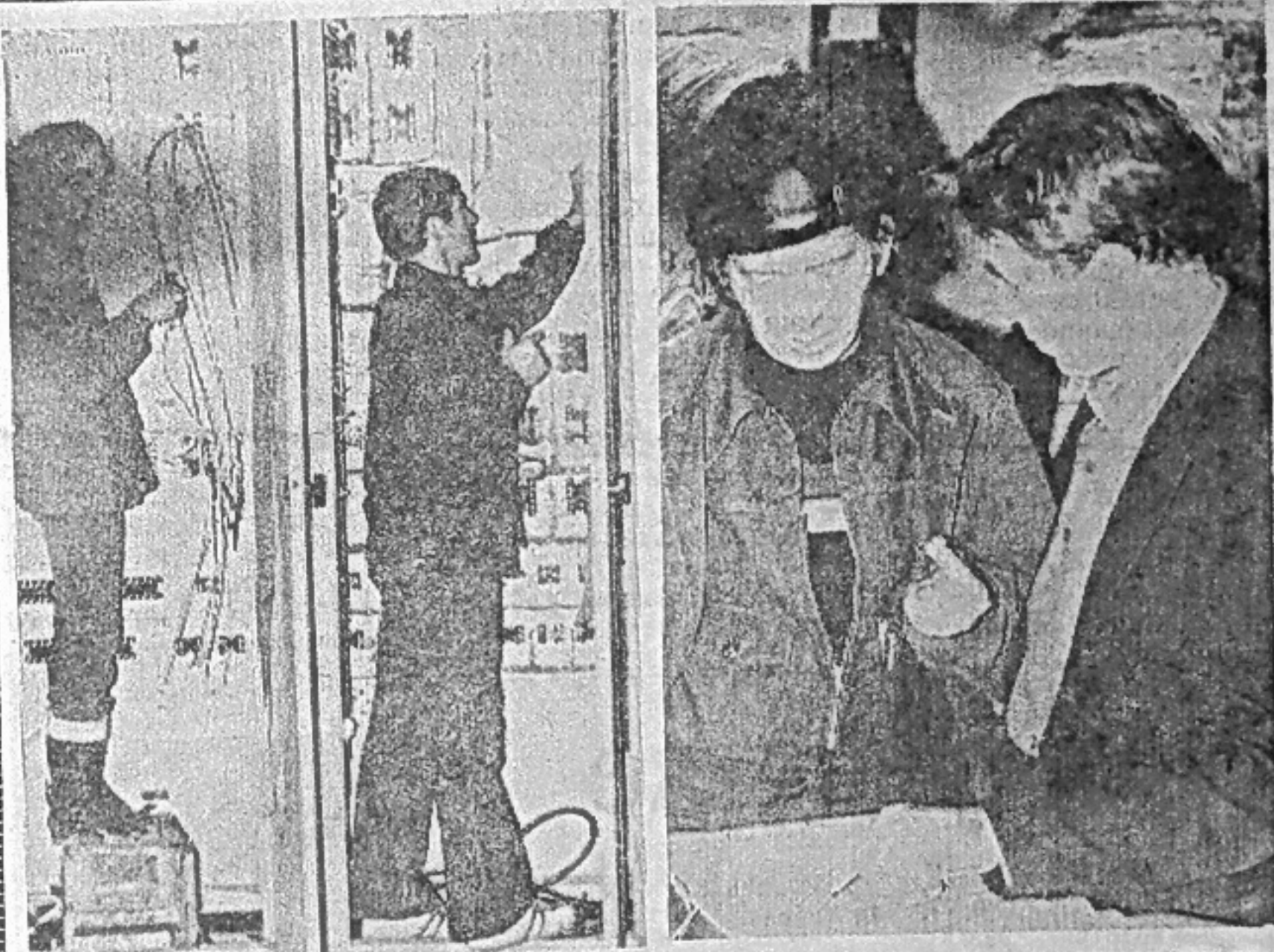
На снимках: идет монтаж коммуникаций второго агрегата, за работой М. Никонова из звена Л. Чечкиной (ГЭМ), инженер-наладчик В. Баландин (фото слева); завершают свои дела на объекте инженер-наладчик Н. П. Поленок и старший инженер объединения «Электросила» А. П. Макаров.
