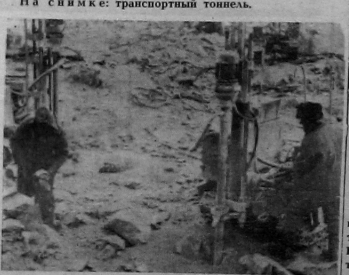
Одним из первых заступил на трудовую вахту в котловане второй очереди коллектив Гидроспецстроя — бурильщики и взрывники. Они внесли большой вклад в досрочное выполнение задания по укладке первого бетона в стационарную часть плотины. На снимке: штурм скалистого дна Енисея продолжается. Фото Г. КАНУНИКОВА.
