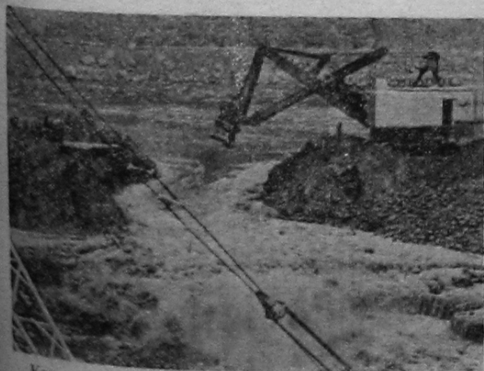
Как уже сообщалось, 4 октября была разомкнута низовая перемычка котлована первой очереди. На снимках: разборка низовой перемычки; общий вид затопленного котлована.
