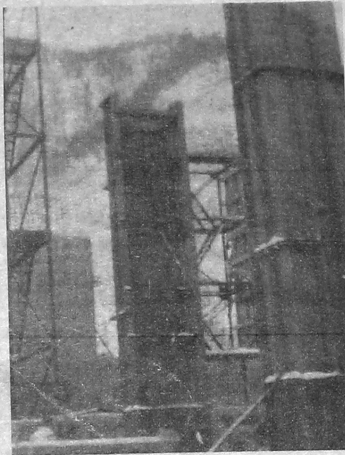
На снимке: в котловане Саяно-Шушенской ГЭС. Пазовые конструкции строительных отверстий первого яруса. Здесь ведет монтажные работы коллектив Гидромонтажа.
