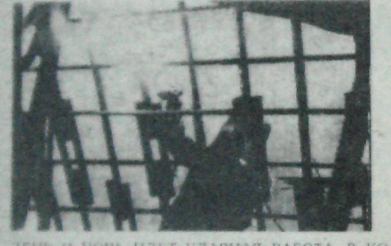
ДЕНЬ И НОЧЬ ИДЕТ УДАРНАЯ РАБОТА В КОТЛОВАНЕ СТРОИТЕЛЬСТВА САЯНСКОЙ ГЭС. НА СНИМКЕ СОЛНЕЧНЫЕ ВСПЫШКИ ЭЛЕКТРОСВАРКИ ИДЕТ УСТАНОВКА АРМАТУРЫ В БЛОКАХ.
