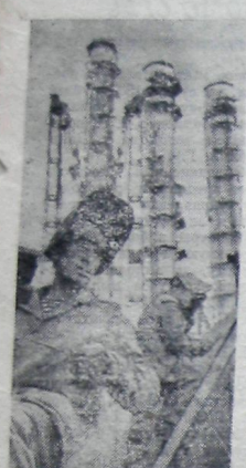
тификационных колонн второй очереди цехов изополимерного каучука Нижнекамского нефтехимического комбината бригада, которую возглавляет опытный строитель Аркадий Устюгов. На снимке: передовой электросварщик Ренат Агутаулин из бригады Аркадия Устюгова на монтаже ректификационных колонн. Фото В. Мясникова. «Фотохроника ТАСС».
