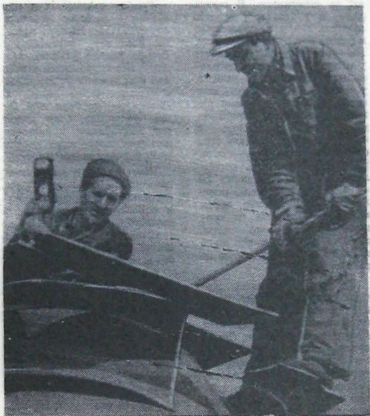
Комплексная бригада А. И. Котова механического цеха сейчас выполняет заказ гидростроителей — им необходимо изготовить днища к силосам цементных складов, для бетонных заводов Означенного и Черемушек. На снимке вы видите членов бригады Виктора Демина и Валентина Армашова за работой.
